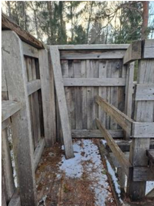
Kuva 19. Ylätasanteen irronnut kaide.
