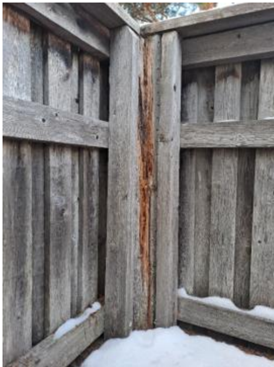
Kuva 15. Kaiteen sivutolpan lahovaurio.
