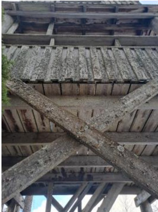
Kuva 13. Jäkälä peittää rakenteita.
