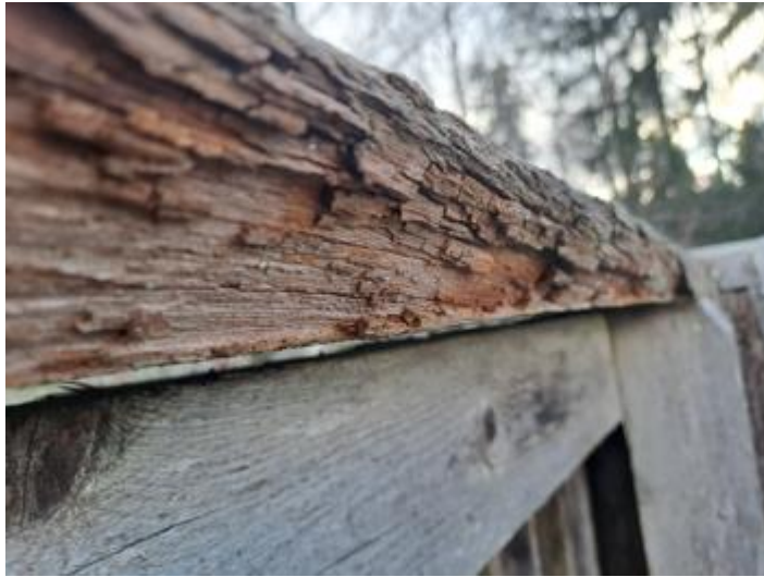
Kuva 17. Kaiteen kansipuun lahovaurio.
