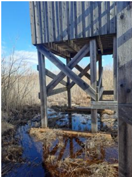
Kuva 105. Vesi nousee tornin alla.
