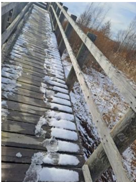
Kuva 66. Rampin puuttuva alakaide.
